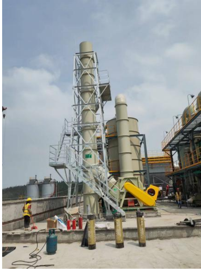
铝灰处理间含氨空气吸收塔（酸洗喷淋塔）+排气筒（DA003）
