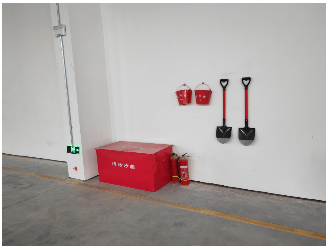
原料库分区及消防设施
