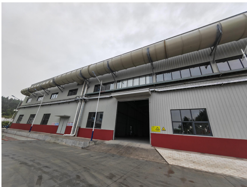
原料库废气收集管道
