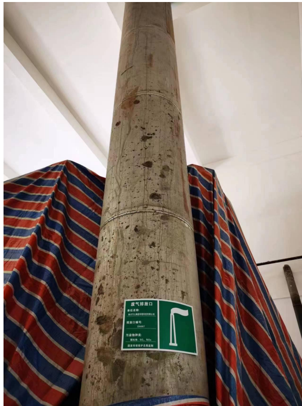
锅炉废气排放口（DA007）
