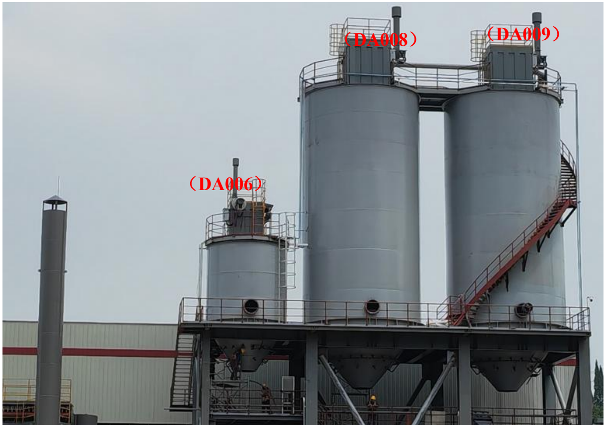
铝灰缓冲仓、生石灰仓仓顶布袋除尘+排放口
