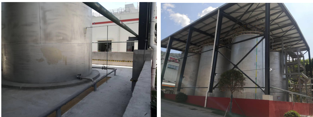
氨水储罐及其围堰
