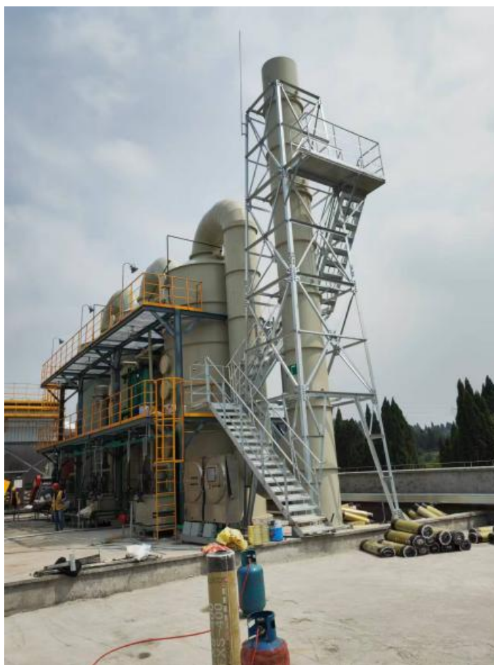
高铝料烘干废气治理设施+排气筒（DA004）
