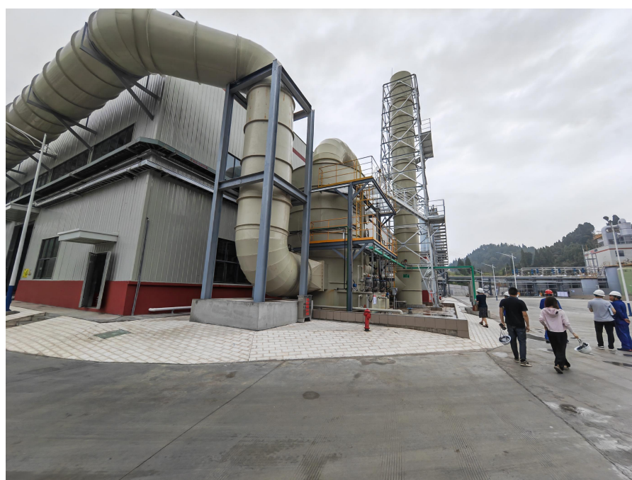
含氨废气吸收塔（酸洗喷淋塔）+排气筒（DA001）
