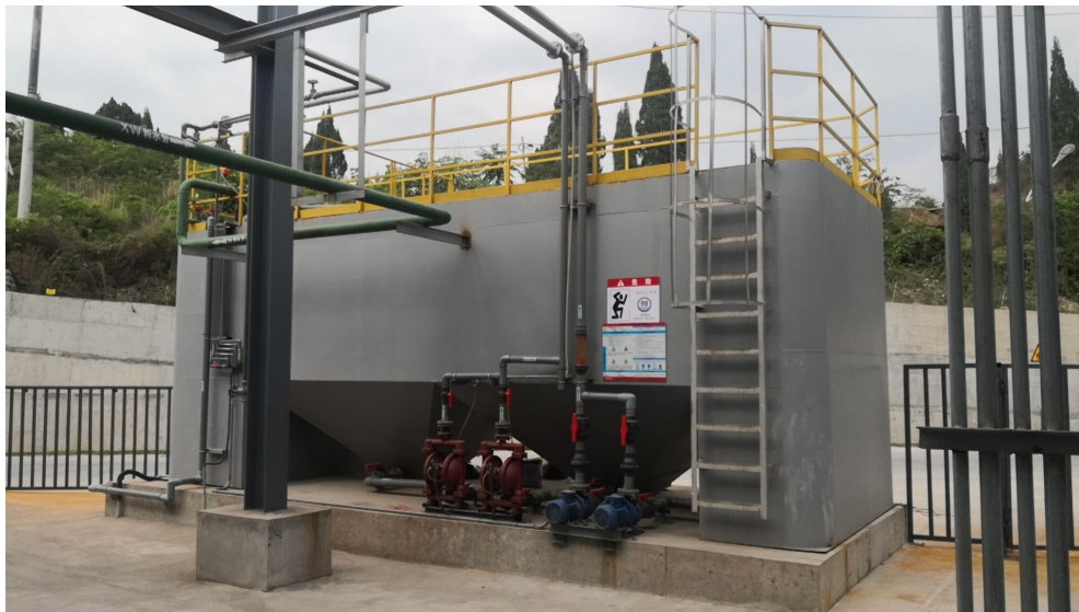
生产废水处理站
