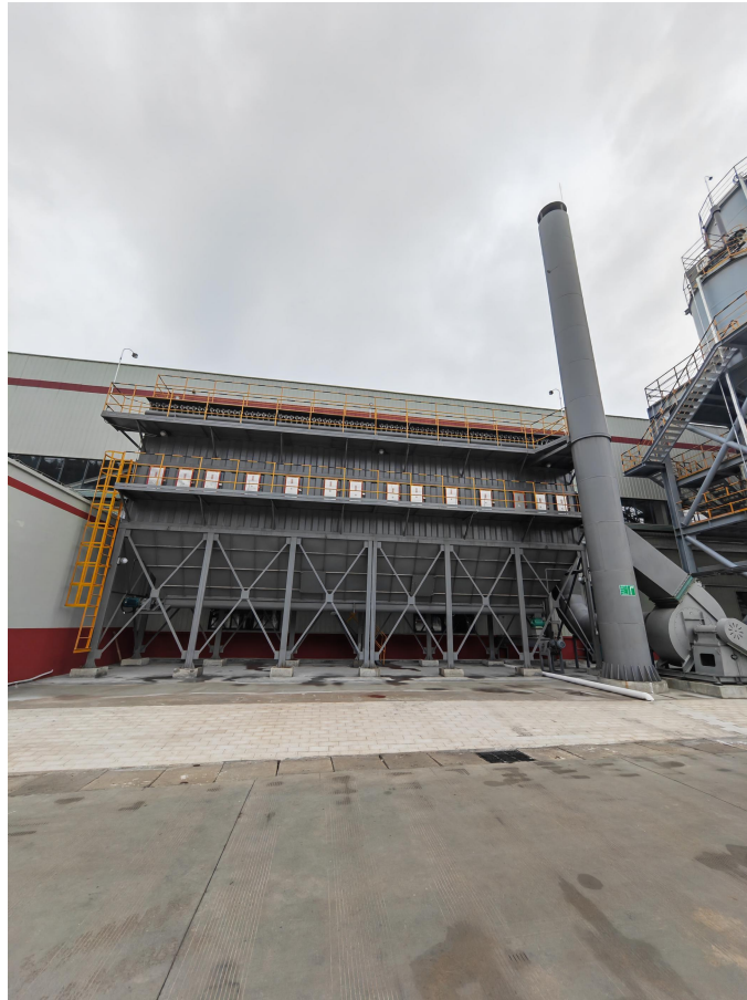
铝灰渣提铝车间废气布袋除尘+排气筒（DA002）
