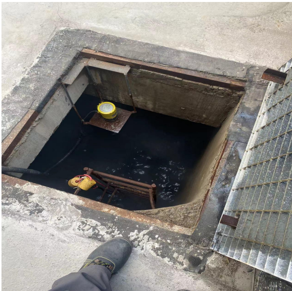
冷却水循环水池
