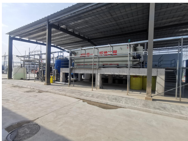
林丰铝电生产废水处理站
