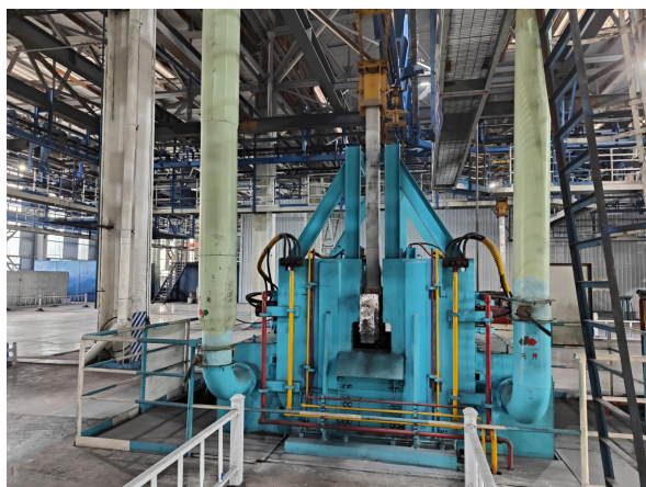
磷铁环压脱集气设施
