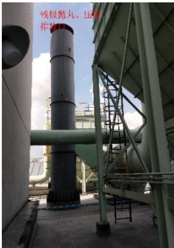
残极压脱粉尘除尘器及其排气筒
