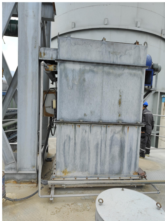
石灰石仓顶布袋除尘器
