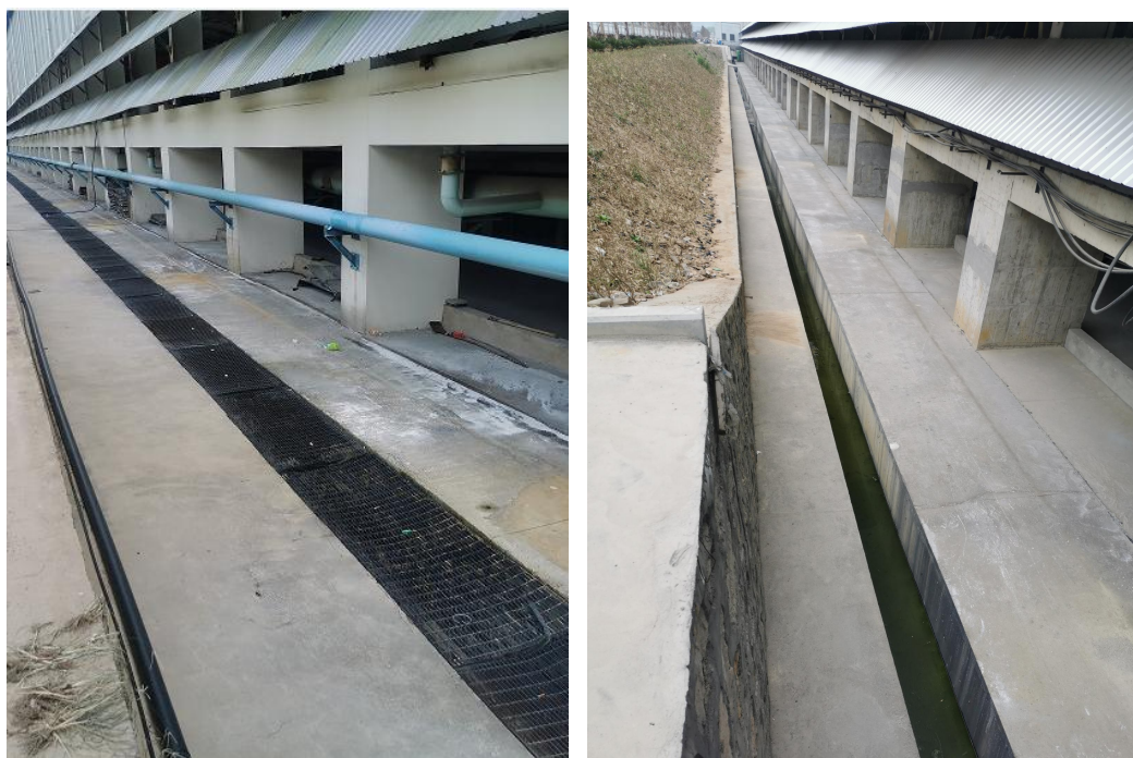
图 2-5 初期雨水收集沟
