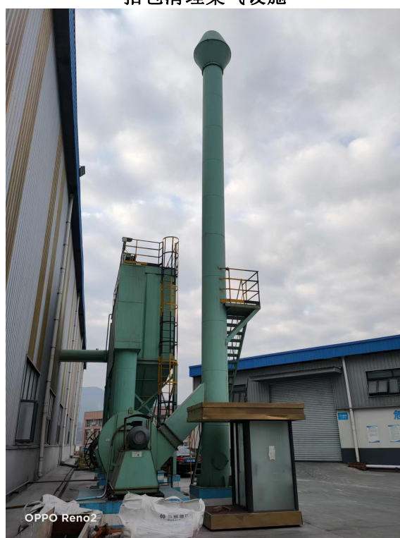
抬包清理粉尘除尘器及其排气筒
