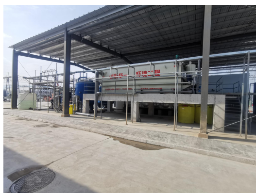
林丰铝电生产废水处理站
