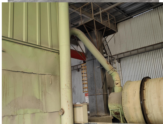
烘干工序收尘及除尘设施
