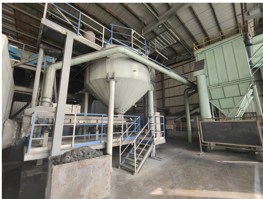
炭渣处理工段集气及除尘设施
