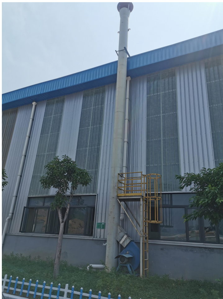
炭渣破碎、球磨及原料储运粉尘排气筒
