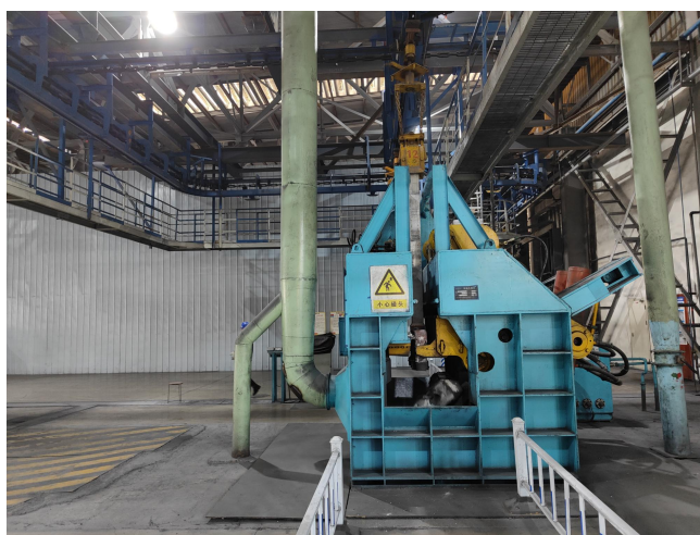
残极压脱集气设施
