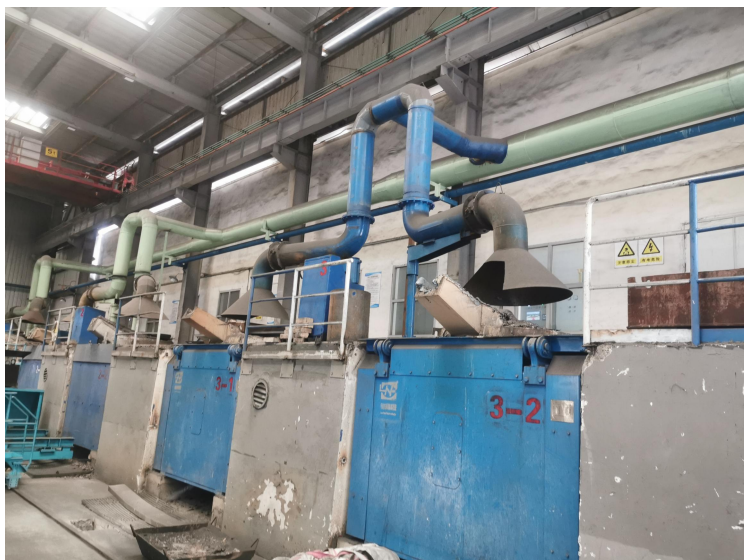
中频炉集气设施及管道
