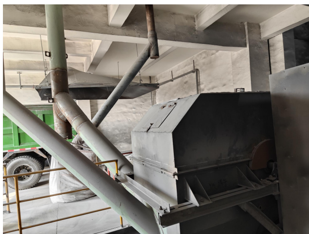
反击破碎机收尘设施
