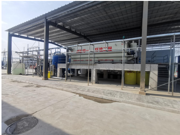
林丰铝电生产废水处理站
