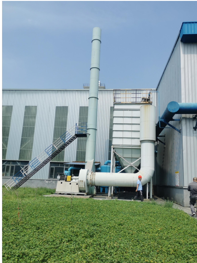
磷铁环压脱及滚筒清理粉尘除尘器及其排气筒
