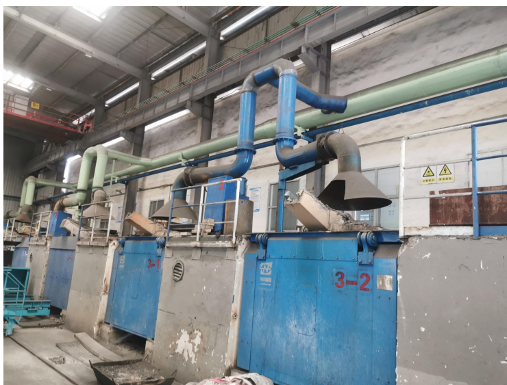
中频炉集气设施及管道
