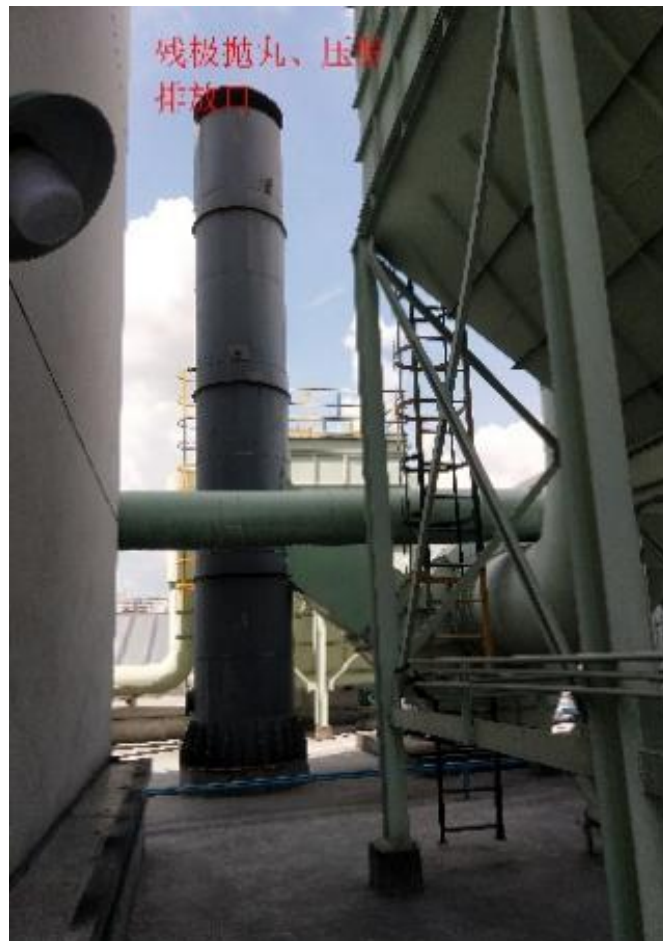
残极压脱粉尘除尘器及其排气筒
