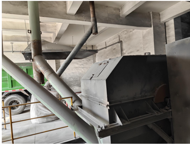
反击破碎机收尘设施
