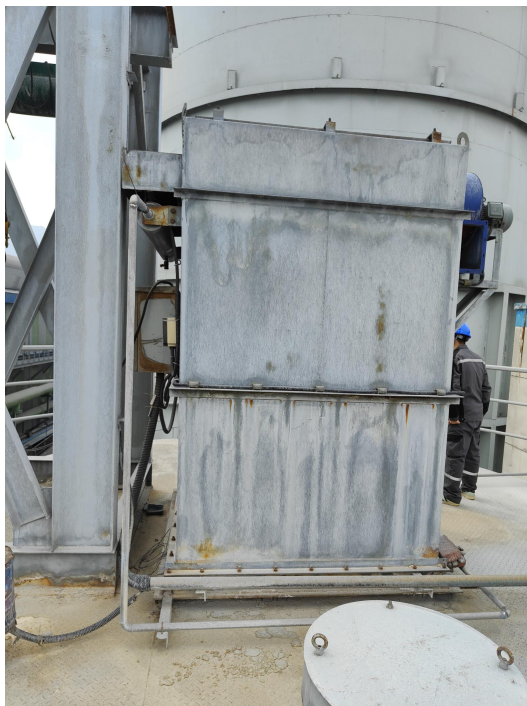
石灰石仓顶布袋除尘器
