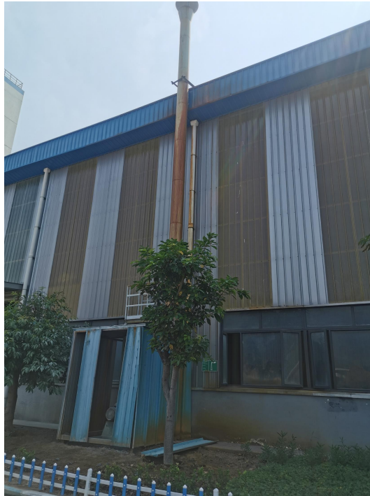
炭渣处理电解质烘干及成品储运废气排气筒
