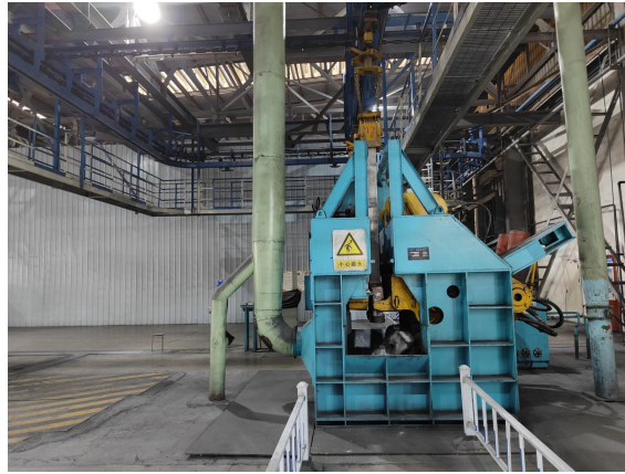
残极压脱集气设施
