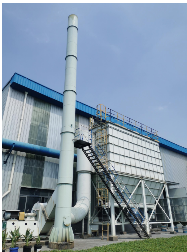
中频炉熔炼和浇注粉尘除尘器及其排气筒
