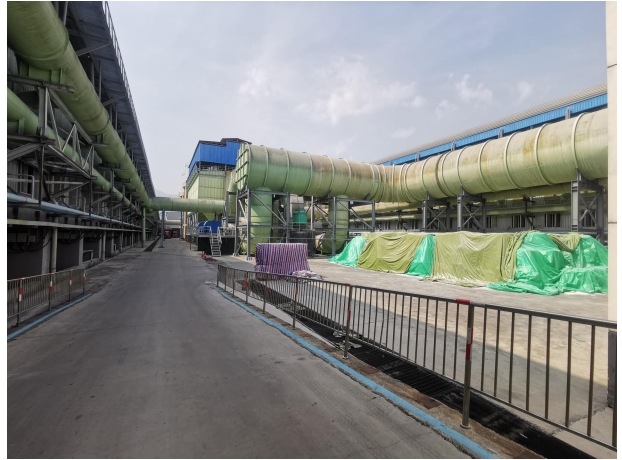
电解烟气收集管道
