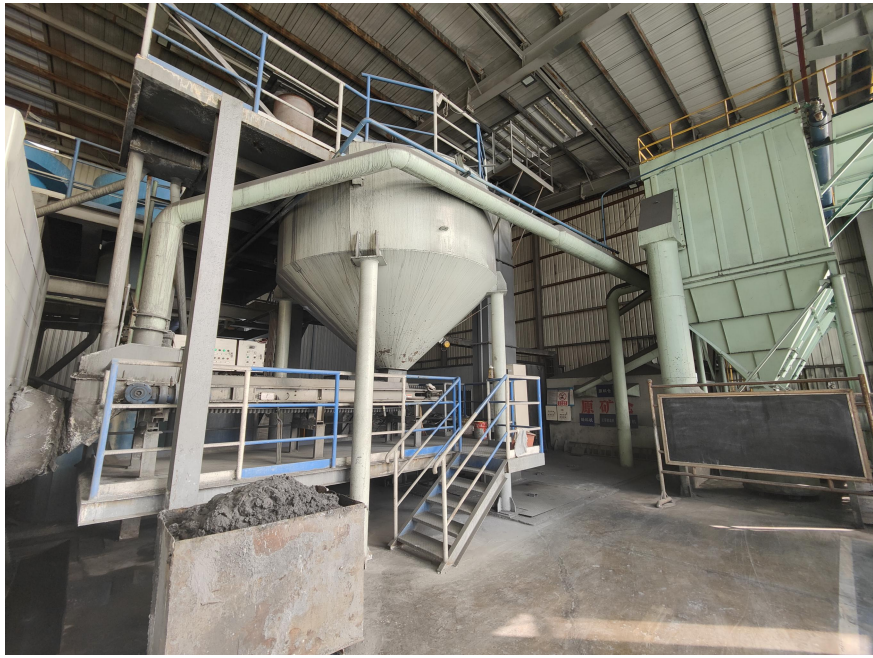
炭渣处理工段集气及除尘设施
