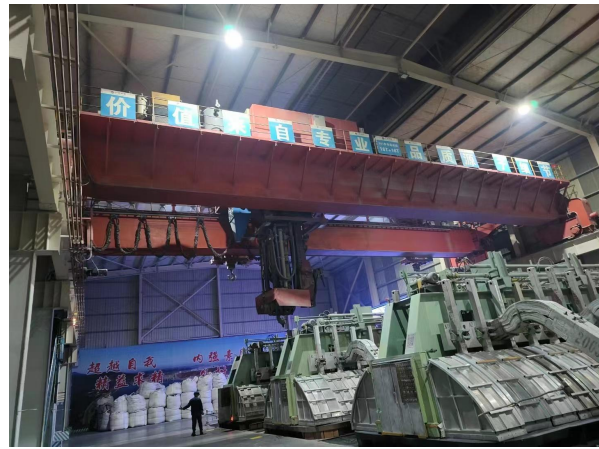
电解车间天车机组收尘装置
