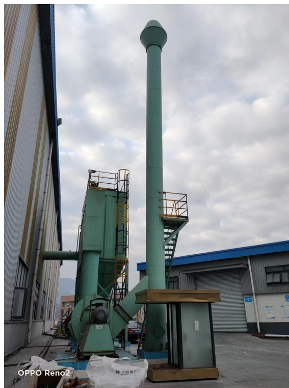
抬包清理粉尘除尘器及其排气筒
