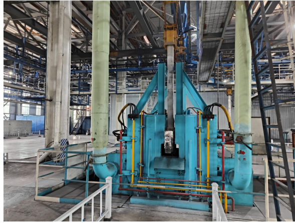
磷铁环压脱集气设施
